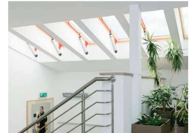
Przykładowa zabudowa okien oddymiających.
